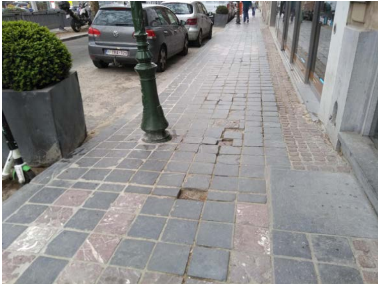
Afbeelding 45: Smalle trottoirs en beschadigde verharding in de Waterloolaan.
