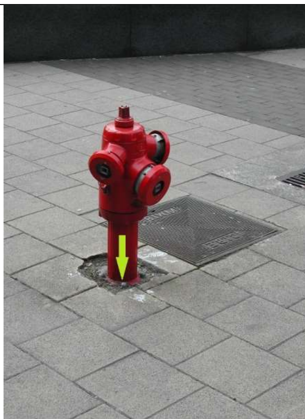
Hydrant (brandkraan): « BM696 »
