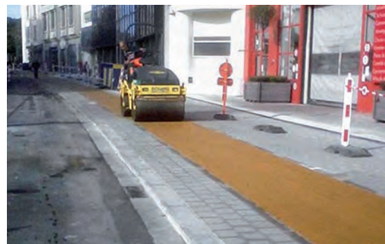
Figuur 15 – Willebroekkaai – Vernieuwing van fietspaden met okerkleurig asfalt – Het fietspad op de foto hierboven is te smal.
