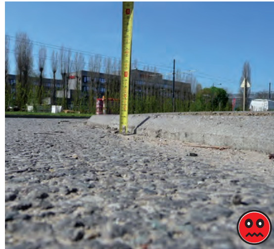
Figuur 54 – Voorbeeld van een slechte aansluiting van het fietspad op de rijbaan.
