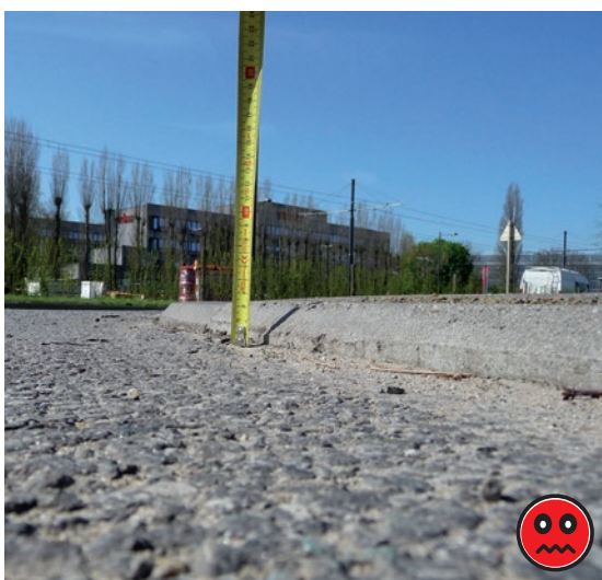
Figuur 9 – Leopold III-laan, boordsteen – Deze boordsteen heeft geen goede vormgeving om fietsers veilig op en van de boordsteen te laten rijden.
