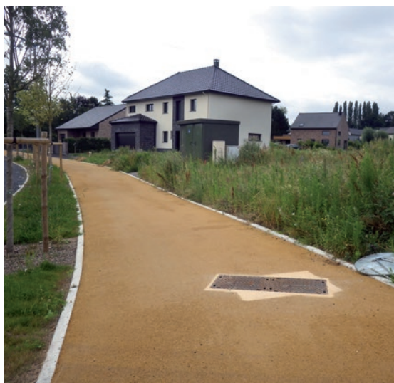
Onesthetische reparatie doordat voor de verharding twee afwijkende okertinten zijn gebruikt.
